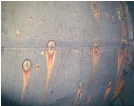
Hình 3. Ăn mòn ôxy trên ống lửa của nồi hơi
