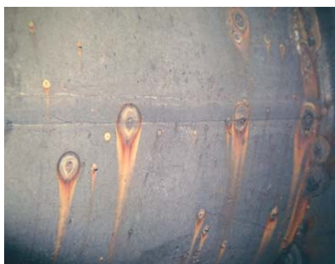
Hình 3. Ăn mòn oxy trên ống lửa của nồi hơi kiểu nằm ngang
