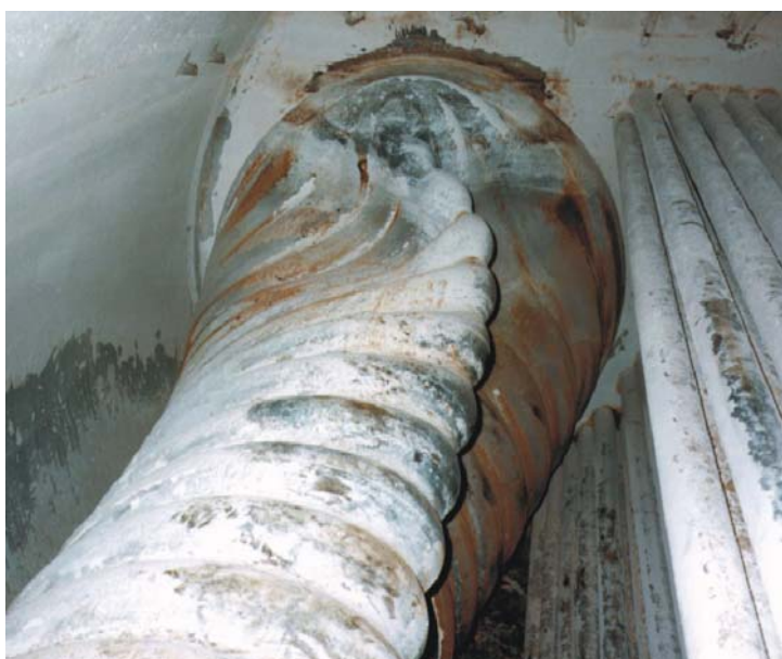
Hình 1. Lớp cặn silic mỏng đã làm cho ống lửa của nồi hơi bị quá nhiệt và biến dạng mạnh.
